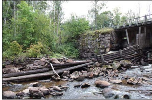
Figur 34. Flottningsrännan var i dåligt skick och hade delvis rasat samman. Foto från nordost.
