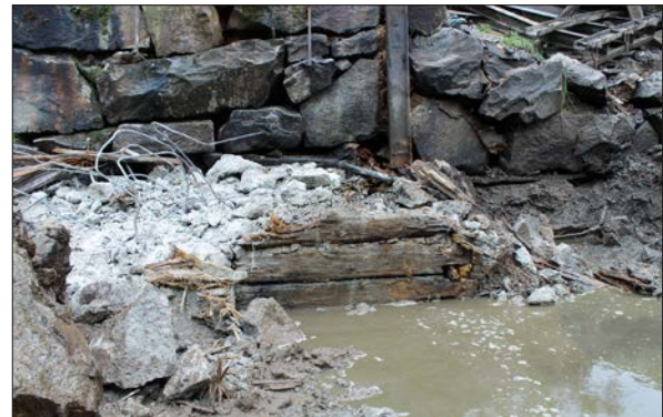
Figur 31. Stora mängder armeringsjärn var ingjutna i betongen och inne i utskovet fanns en träkonstruktion fylld med betong och sten. Foto från nordost.
