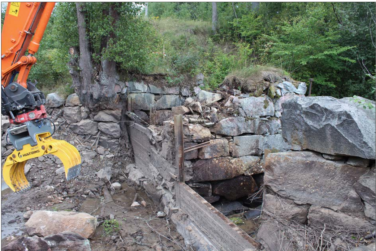
Figur 25. Det mellersta fundamentet i norra utskovet revs för att öka vattenflödet. Foto från söder.
