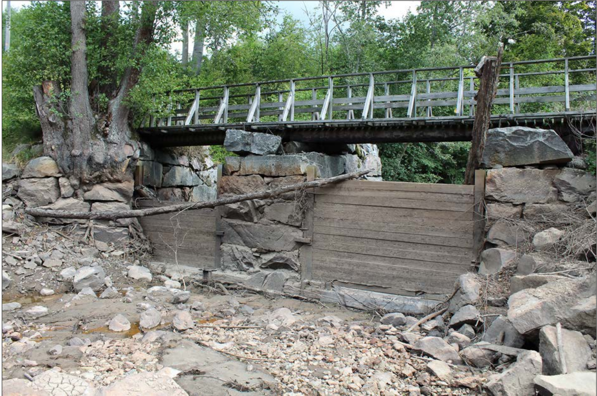
Figur 24. Norra utskovet var igensatt med stockar. Foto från väster.
